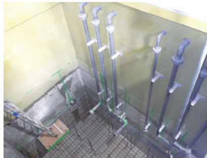
地下水槽の内部写真
